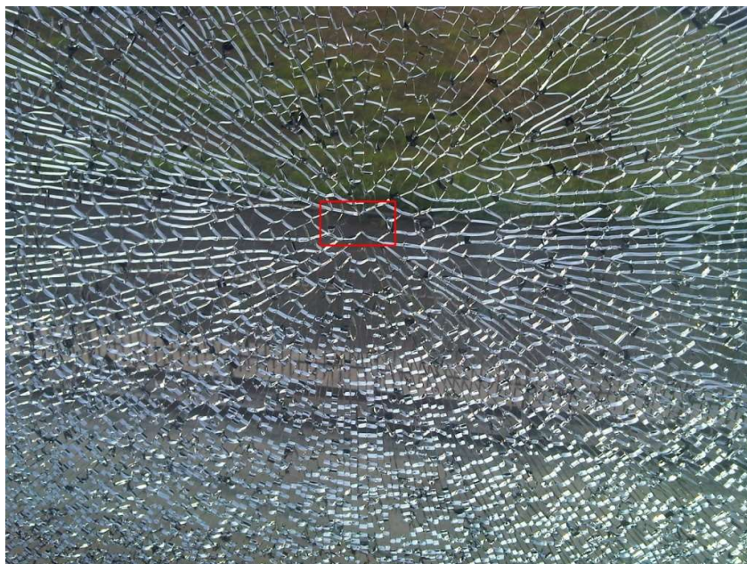
Fig. 32: Rottura di vetro temperato a causa di inclusioni di solfuro di nichel
